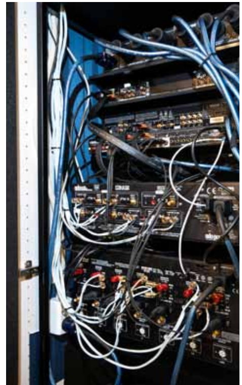
Baksidan på AV-racket i maskinrummet bjuder på fin ordning trots en omfattande kabelhärva!
